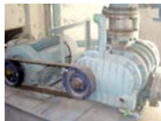
ブロワ、ファン などのメンテナンス！
