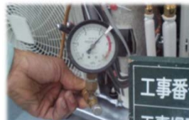
フロン点検をしていない
