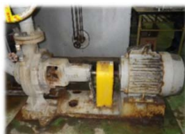
ポンプの錆防止の ためのコーティング
