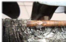
冷媒漏れの防止
